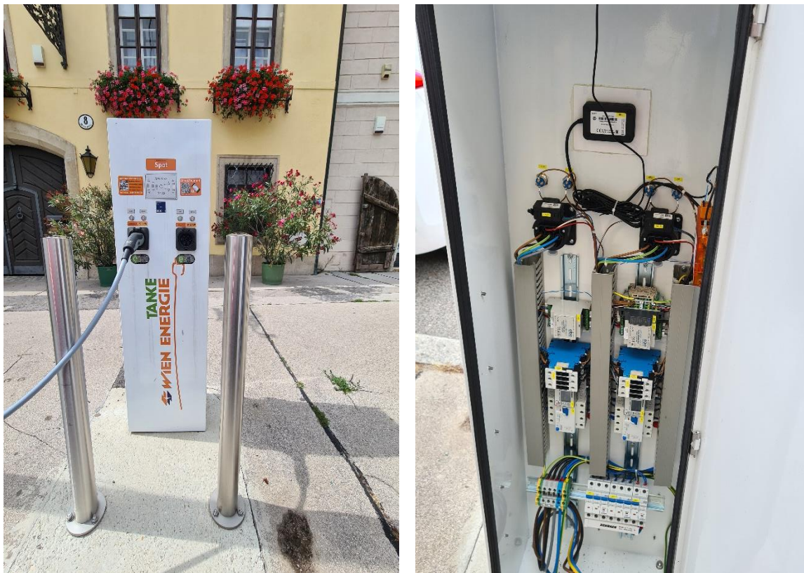
Abbildung 6: Elektro-Ladestation in 2380 Perchtoldsdorf, Marktplatz 10
