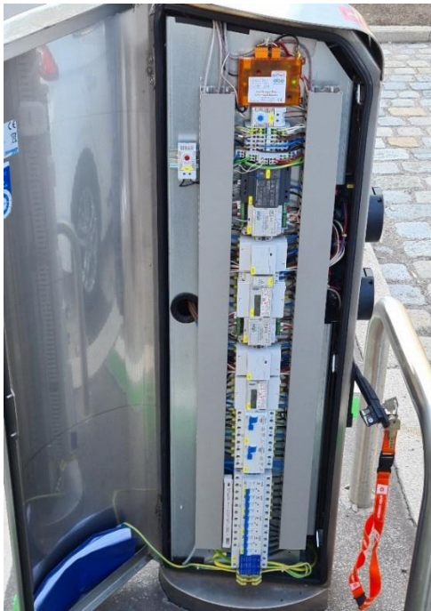
Abbildung 2: Innenansicht der Elektro-Ladestation in Wien 3, Erdbergstraße 139, Auffahrt Thomas-Klestil-Platz
