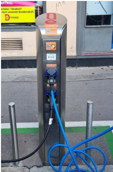
Abbildung 3: Elektro-Ladestation in Wien 1, Morzinplatz vor Nr. 4, mit Ladevorgang von beiden Ladepunkten
